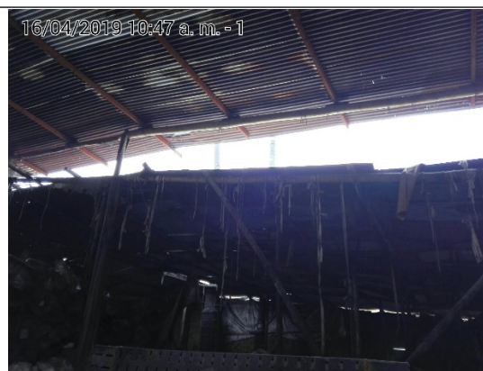
FOTOGRAFÍA No. 7: ÁREAS DE LA BODEGA SIN CONFINAR
